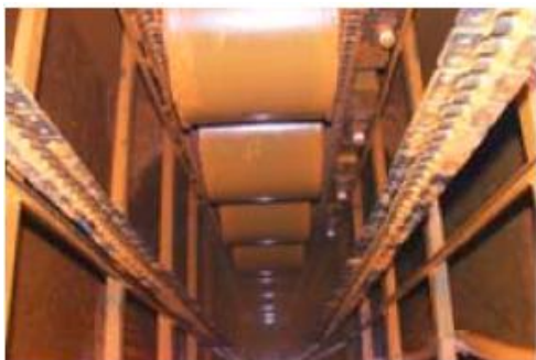
Abbildung 4 Innenansicht Auftriebsbehälter ohne Wasser
