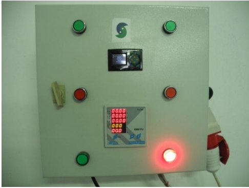
Abbildung 1 Schaltschrank zur Versorgung des Kompressors
