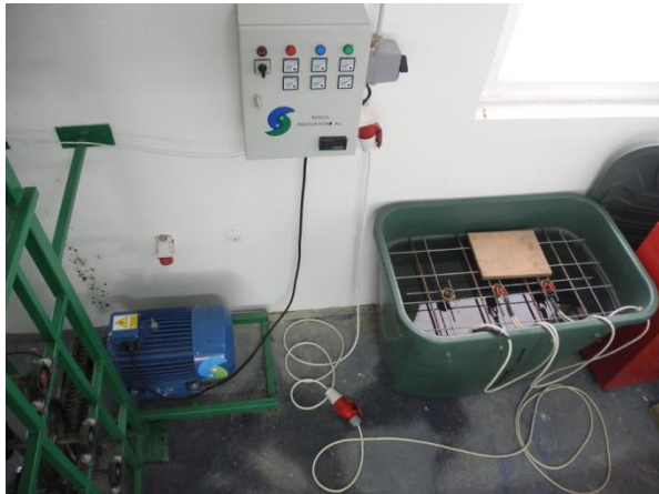
Abbildung 9 Generator mit Schaltschrank und Stromverbraucher
